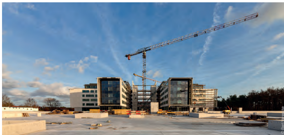
Le grand atrium du nouveau bâtiment de l'hôpital AZ Alma Eeklo a fait l'objet d'une attention particulière au niveau de la protection anti-incendie.
