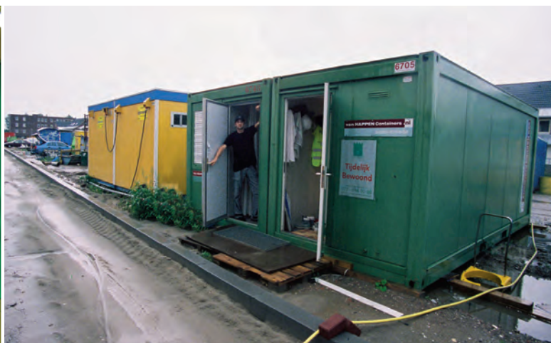
De plaatsing van wooncontainers op bouwerven biedt een 24-uurs aanwezigheid en voorkomt diefstal of vandalisme.
