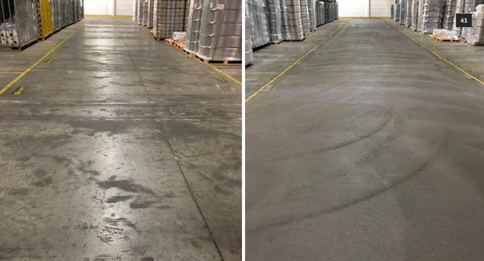
Chez le fabricant de tapis Balta, le sol Latexfalt s'est avéré être une solution adaptée pour les allées en mauvais état. Photos avant (gauche) et après (droite) le traitement
