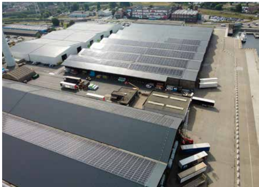
Eind 2021 sloot Stad Gent een stroomafnameovereenkomst af met burgercoöperatie Beauvent en dit voor 15 jaar. Beauvent zal vanaf 2023 jaarlijks 7.000 MWh elektriciteit produceren op de daken van houtimporteur Lemahieu Group aan de Zuiddokweg in Gent.
